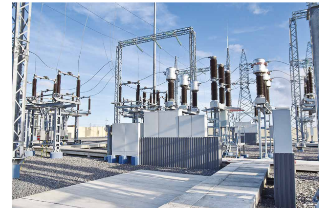
Подстанция 110 кВ «Аульс»
