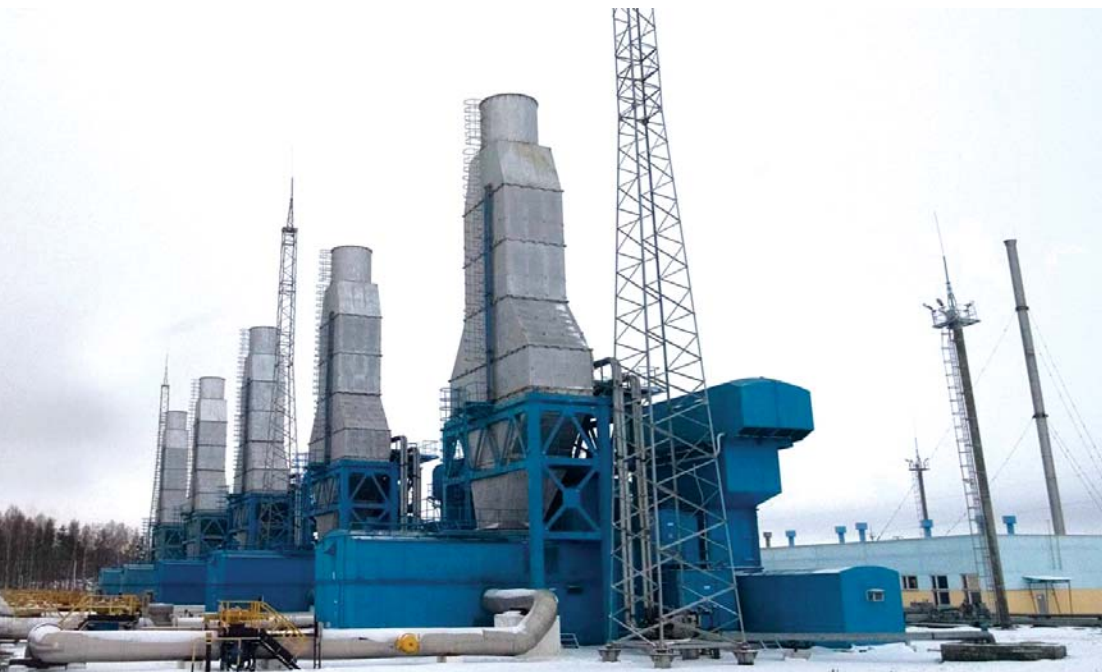
Магистральный газопровод «Ямал – Европа» соединяет месторождения севера Западной Сибири с конечными потребителями в Западной Европе. Несвижская компрессорная станция на белорусском участке газопровода в числе других обеспечивает бесперебойную прокачку газа
